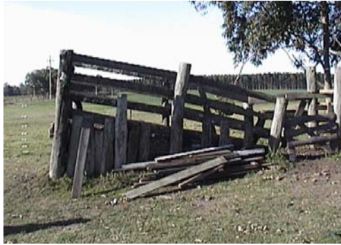
Figura 1. Embarcadero sin mantenimiento, con barandas sueltas y mucha distancia entre ellas, barandas sueltas caídas.
